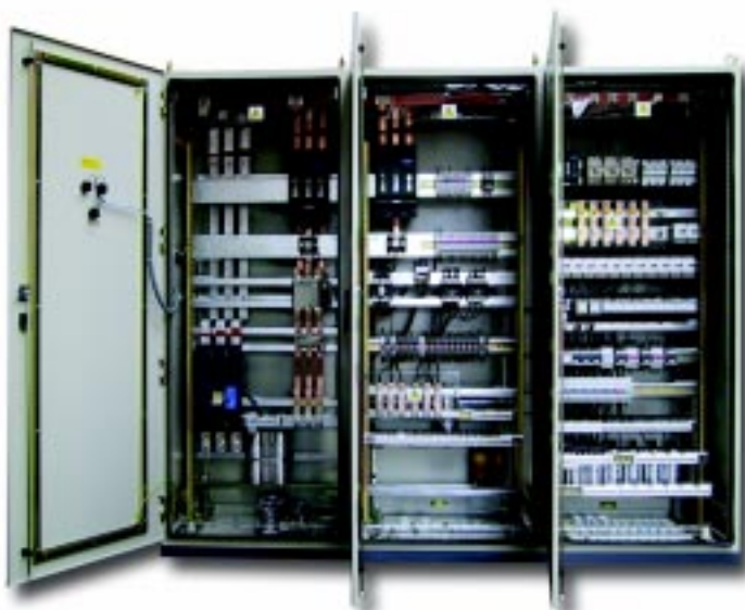
Hlavní napájecí rozváděč
