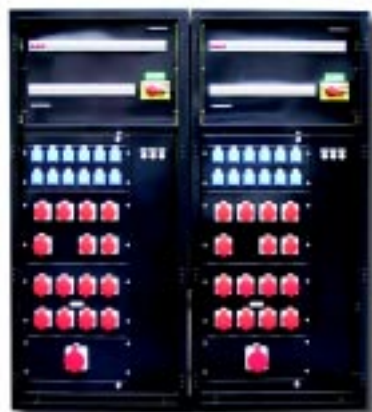
Zásuvkový rozváděč - zák. centrum ŠKODA AUTO a.s.
