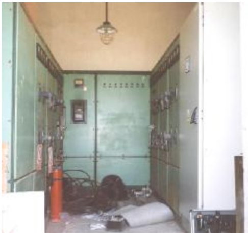
Rozvodna NN před rekonstrukcí ...
