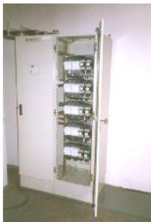
. . . a nový modulový rozváděč.
